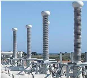
HV Bushing PLTA ASAHAN (2X90 MW)
