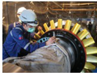
Labyrinth Rotor Generator PLTU PANGKALAN SUSU UNIT 1 dan 2 (2 x 200 MW)
